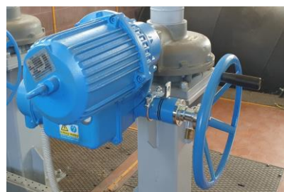
Kit di emergenza su Att. Elettrico DREHMO
