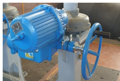
Kit di emergenza su Att. Elettrico DREHMO
