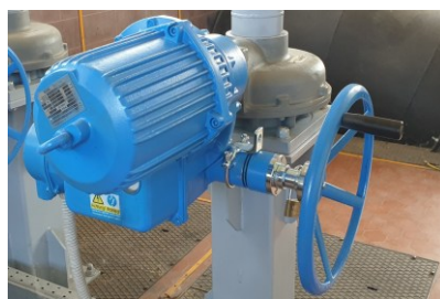
Kit di emergenza su Att. Elettrico DREHMO
